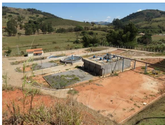
Figura 18: Vista geral da ETE.
