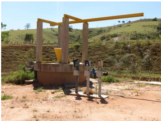
Figura 15: Estação elevatória da ETE.
