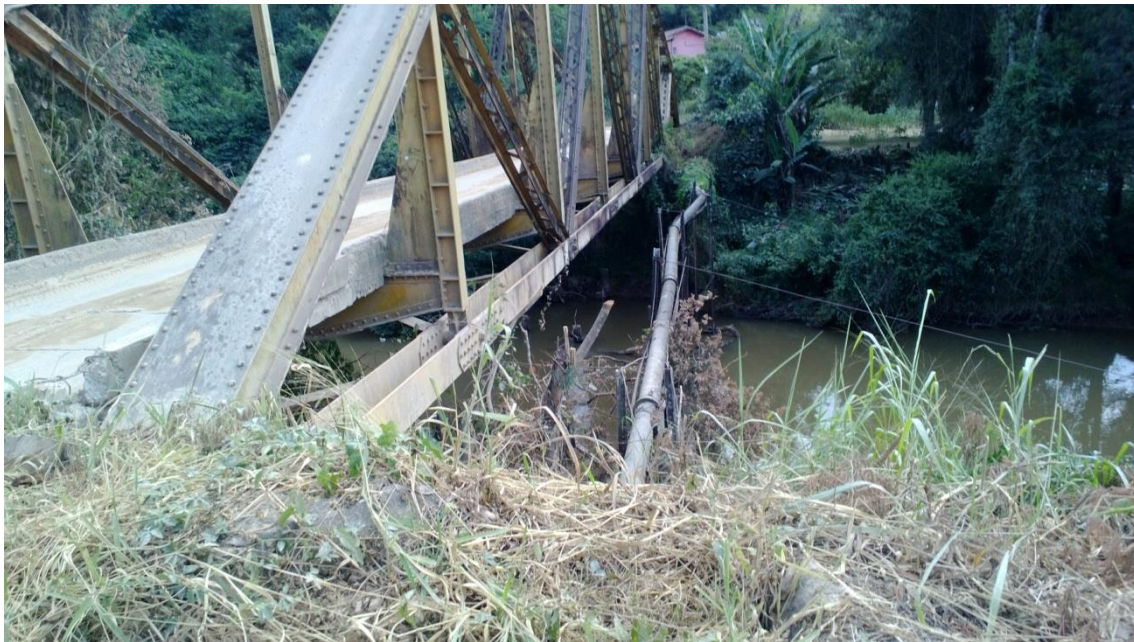
Figura 3.18 – Adutora de Água Bruta
