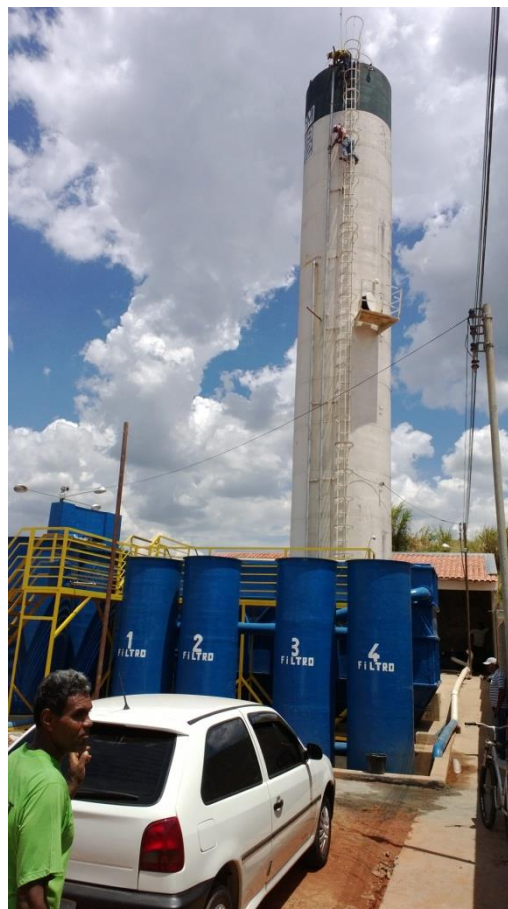
Figura 3.32 – Detalhes da ETA do Parque Coronel Rennó
