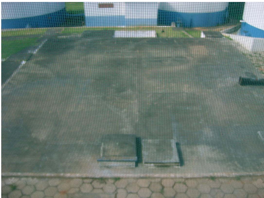
Figura 3.23 – Reservatório enterrado, localizado na ETA principal
