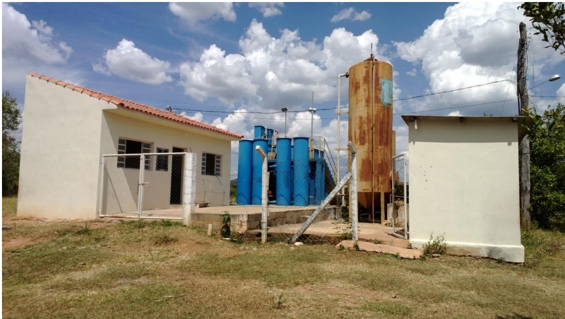
Figura 3.33 – Detalhes da ETA Sapucaí
