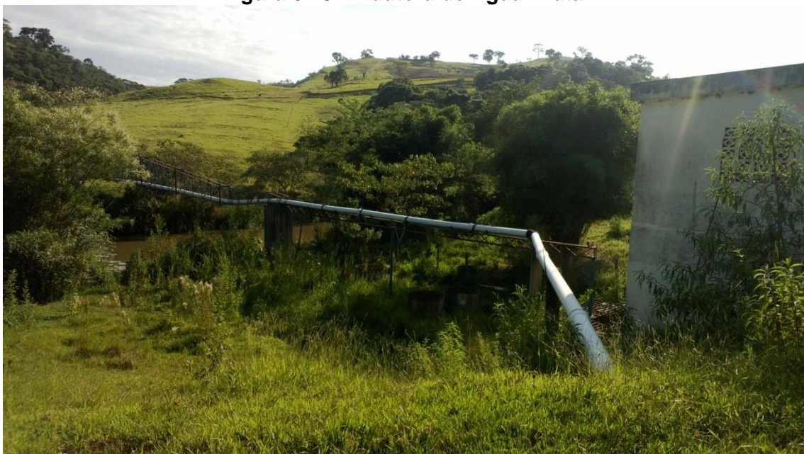
Figura 3.19 – Adutora de Água Bruta
