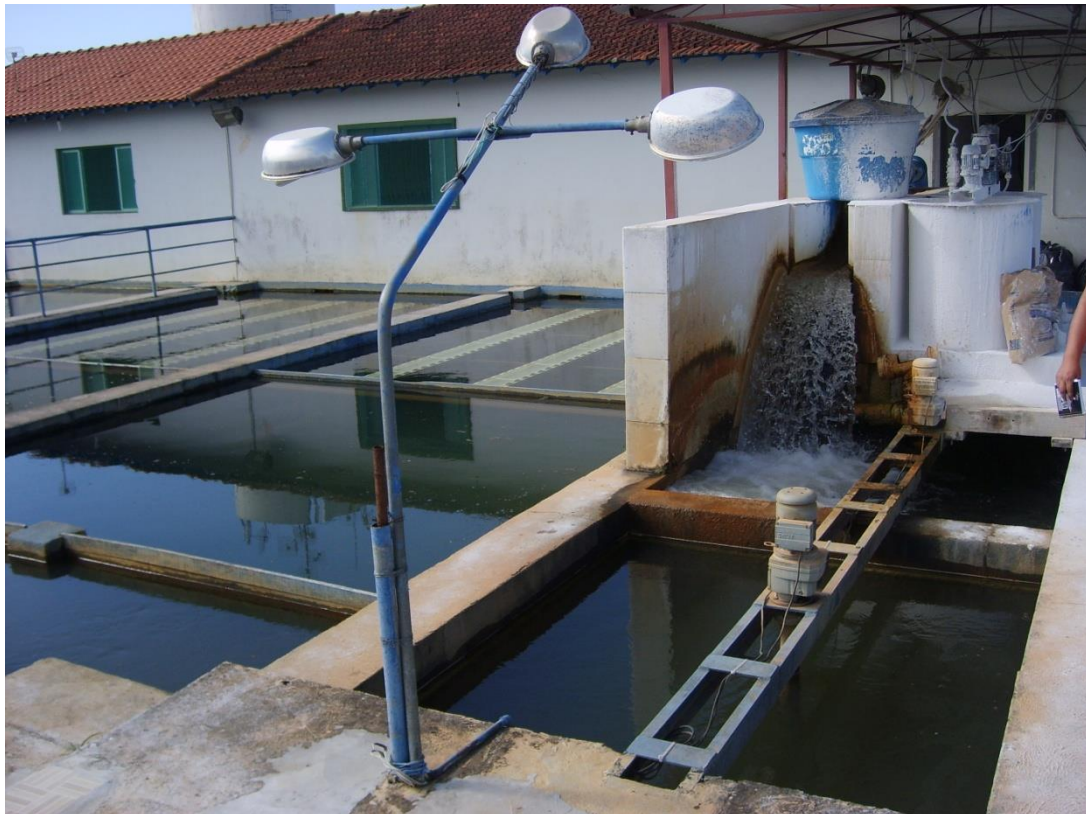
Figura 3.30 – Detalhes da ETA principal
