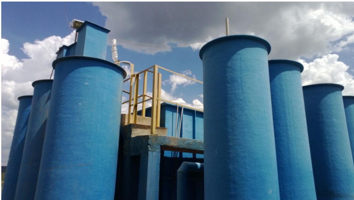
Figura 3.34 – Detalhes da ETA Sapucaí
