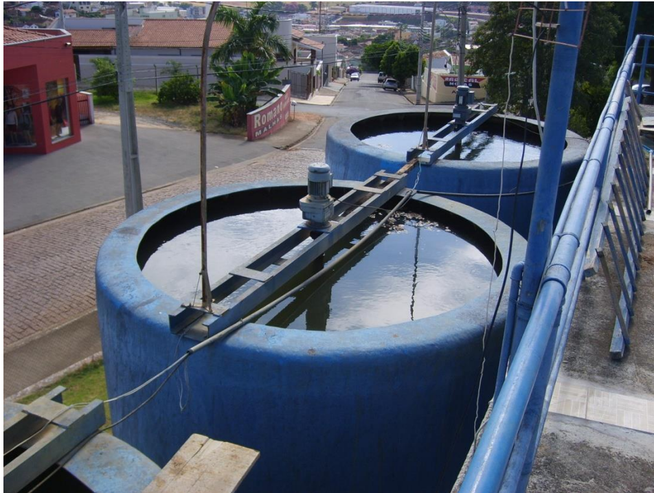
Figura 3.31 – Detalhes da ETA principal
